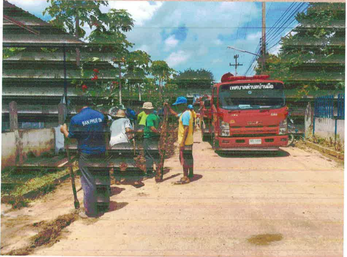
ทำความสะอาดร่องระบายน้ำ บ้านโนนทอง หมู่ที่ 1 ประจำปีงบประมาณ 2563
